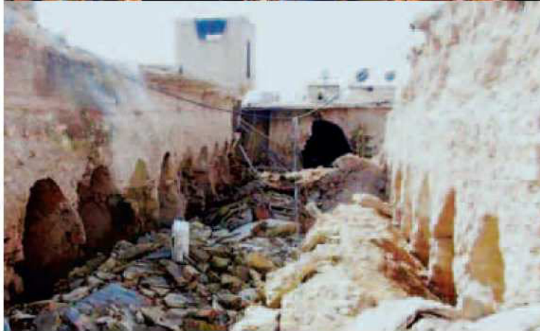
Abb. 7 Der gesamte Basar der Innenstadt wurde zu unterschiedlichen Zeiten stark zerstört. Oben: Textilbasar. Unten: Zusammengebrochene Deckenkonstruktionen. Diese Art von Konstruktion ist sehr selten und schwer zu errichten. Dies wird sicherlich beim Wiederaufbau Probleme bereiten.
